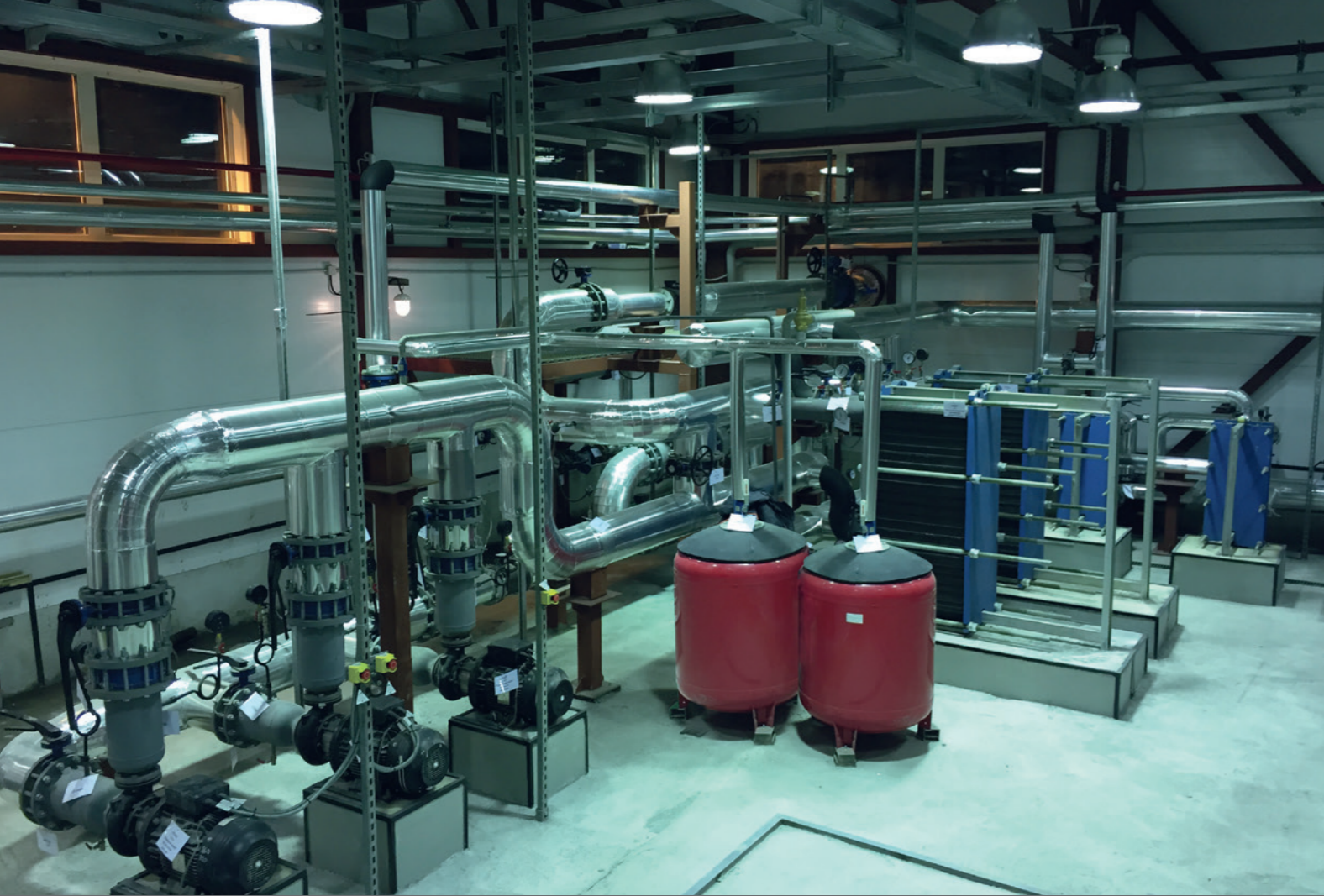
Котельная, г. Апатиты
